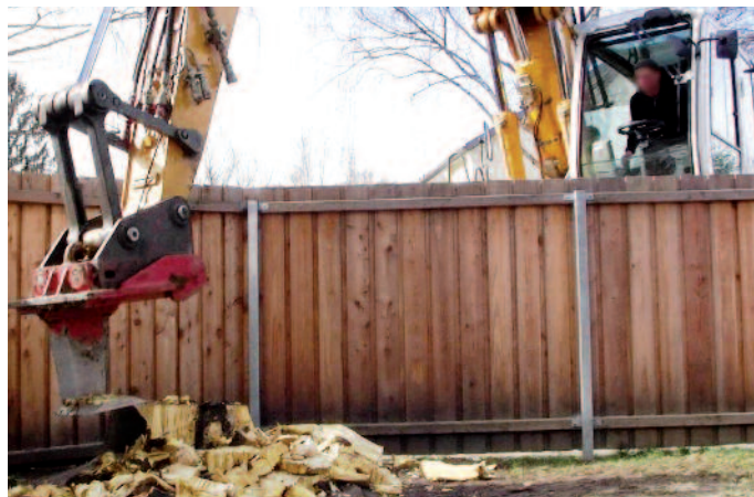
Auf dem Gelände eines Kindergartens ließen sich Wurzeln über einen Zaun hinweg entfernen.
